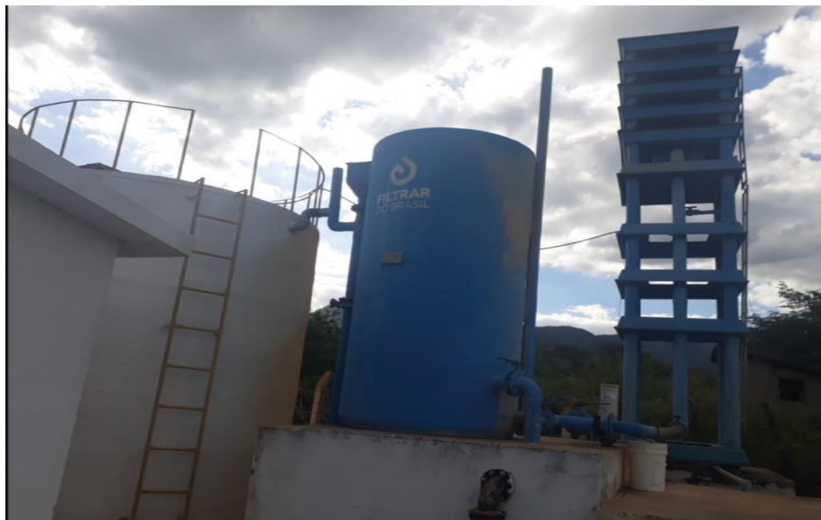
Figura 3 - Estação de Tratamento de Água na localidade de Cedro.
