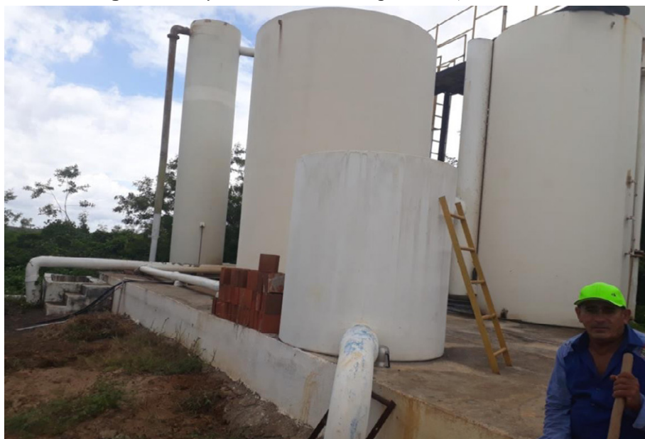
Figura 2 - Estação de Tratamento de Água de São José do Torto.
