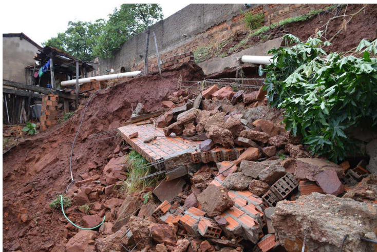
Figura 12 - Rompimento de galeria pluvial no bairro Paroquial
