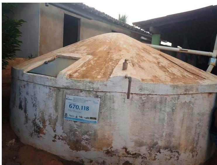
Figura 25 - Cisterna de placa localizada em uma das residências da Comunidade Quilombola Sítio Veiga
