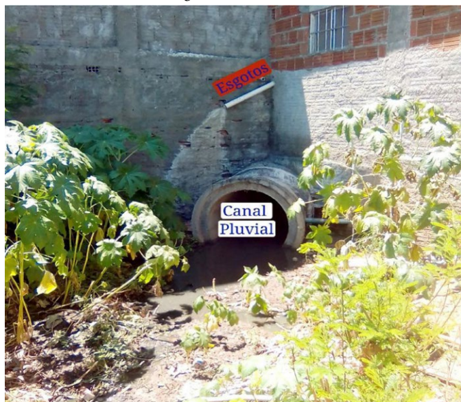
Figura 12 – Meio de descarte das águas cinzas das residências urbanas sem ligação com a rede coletora de esgotos em São Fernando/RN, 2019
