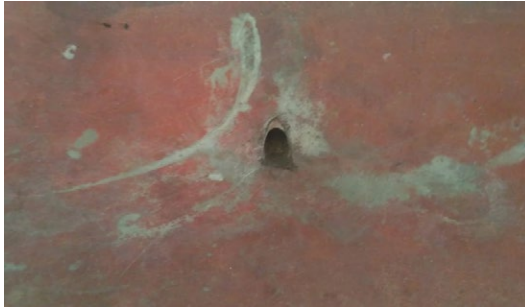
Figura 5 - Ralo inadequado e sem proteção
