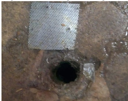
Figura 6 - Ralo inadequado e sem proteção
