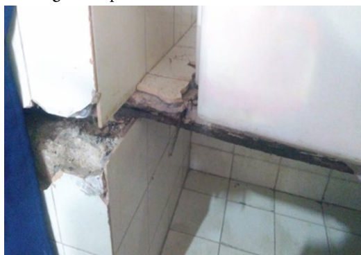
Figura 2 - parede com rachaduras e buracos
