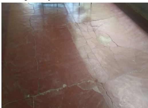
Figura 1 - piso com rachaduras e buracos
