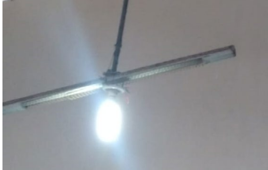
Figura 10 - Luminárias sem proteção
